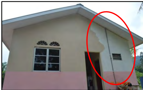
Rumah PBR Kg. Machang, Hulu Terengganu - Rumah Dicat Tidak Sempurna (06.06.2017)
