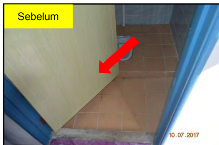
Rumah PBR Kg. Tok Dor, Besut - Pintu Terhalang pada Lantai Tandas (10.07.2017)
