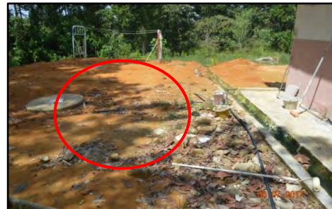
Rumah PBR Kg. Bukit, Setiu - Manhole Tidak Dilaksanakan (06.07.2017)
