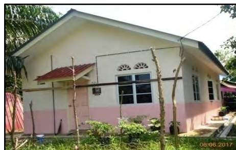
Rumah PBR Kg. Bkt. Kolam, Hulu Terengganu - Binaan Mengikut Pelan Tidak Diluluskan (Pandangan Belakang) (06.06.2017)
