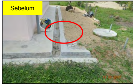
Rumah PBR Kg. Gong Kepas, Besut - Pemasangan Manhole Tidak Dilaksanakan (11.07.2017)
