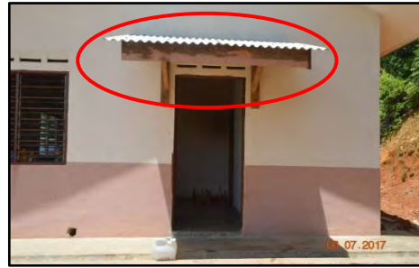
Rumah PBR Kg. Bukit Layat, Setiu - Awning Tidak Dicat Dengan Sempurna (06.07.2017)
