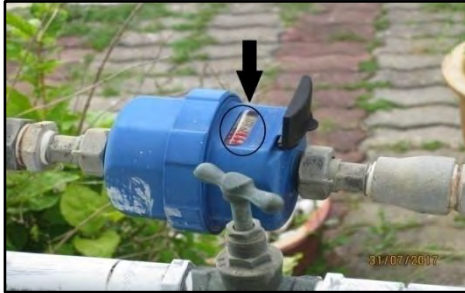
Lokasi: Jalan Dato Amar, Batu Buruk - Bacaan Meter Tidak Bergerak (31.07.2017)
