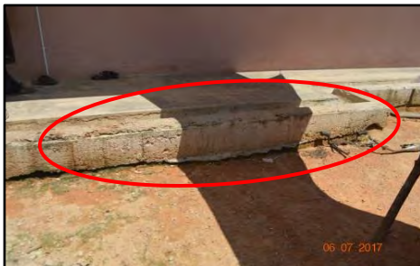
Rumah PBR Kg. Bukit Layat, Setiu - Kemasan Longkang Tidak Sempurna (06.07.2017)
