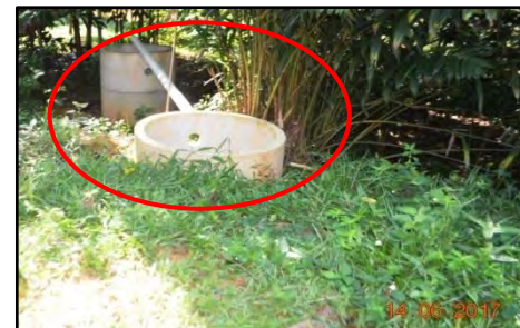
Rumah PBR Kg. Sekayu, Hulu Terengganu - Tangki Septik Tidak Disiapkan (14.06.2017)
