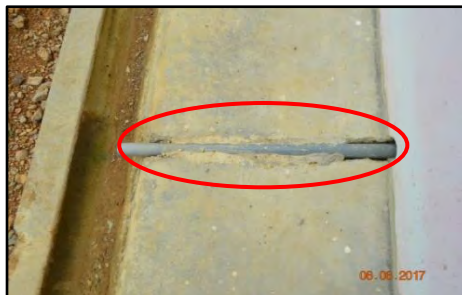
Rumah PBR Kg. Sg. Siput, Hulu Terengganu - Kemasan Saluran Paip Tidak Sempurna (06.06.2017)
